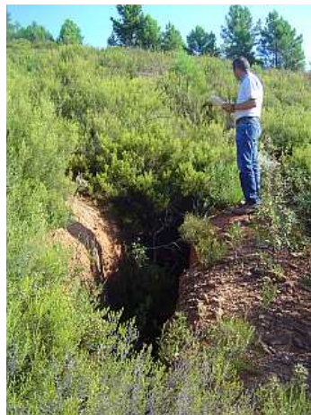
FIGURA 11: Pozo sin protección en antigua explotación de Sn en el término municipal de Torrecilla de los Ángeles.
